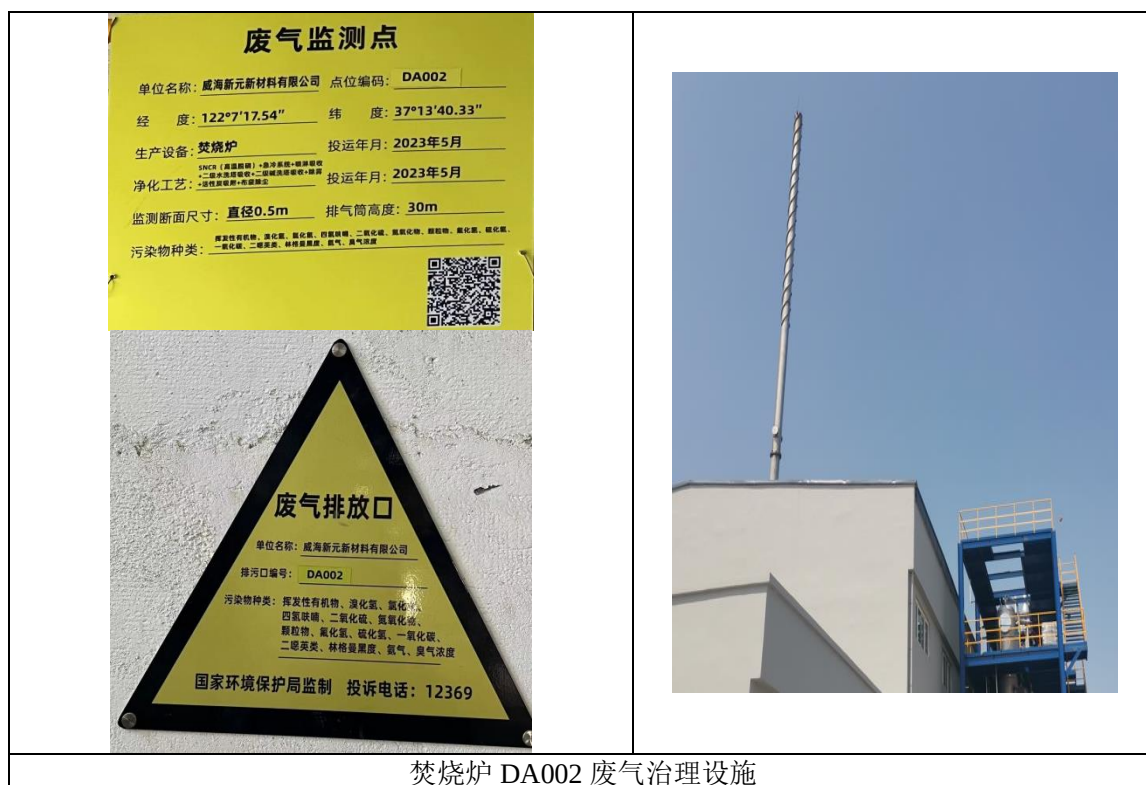
图 12.2-1 现有排气筒及其标志牌设置情况
