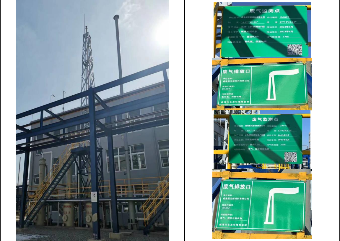
10#车间 DA007（右）和 DA012（左）废气治理设施
