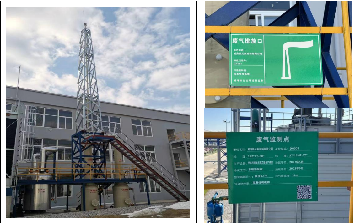
7#车间 DA001 废气治理设施
