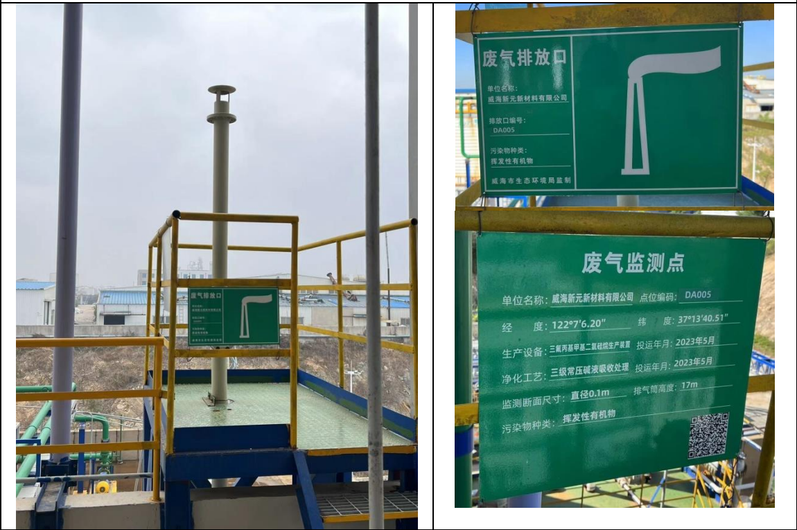
9#车间 DA005 废气治理设施
