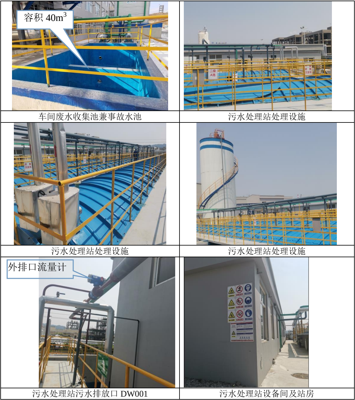
图 6.4-3 污水处理设施实景图
