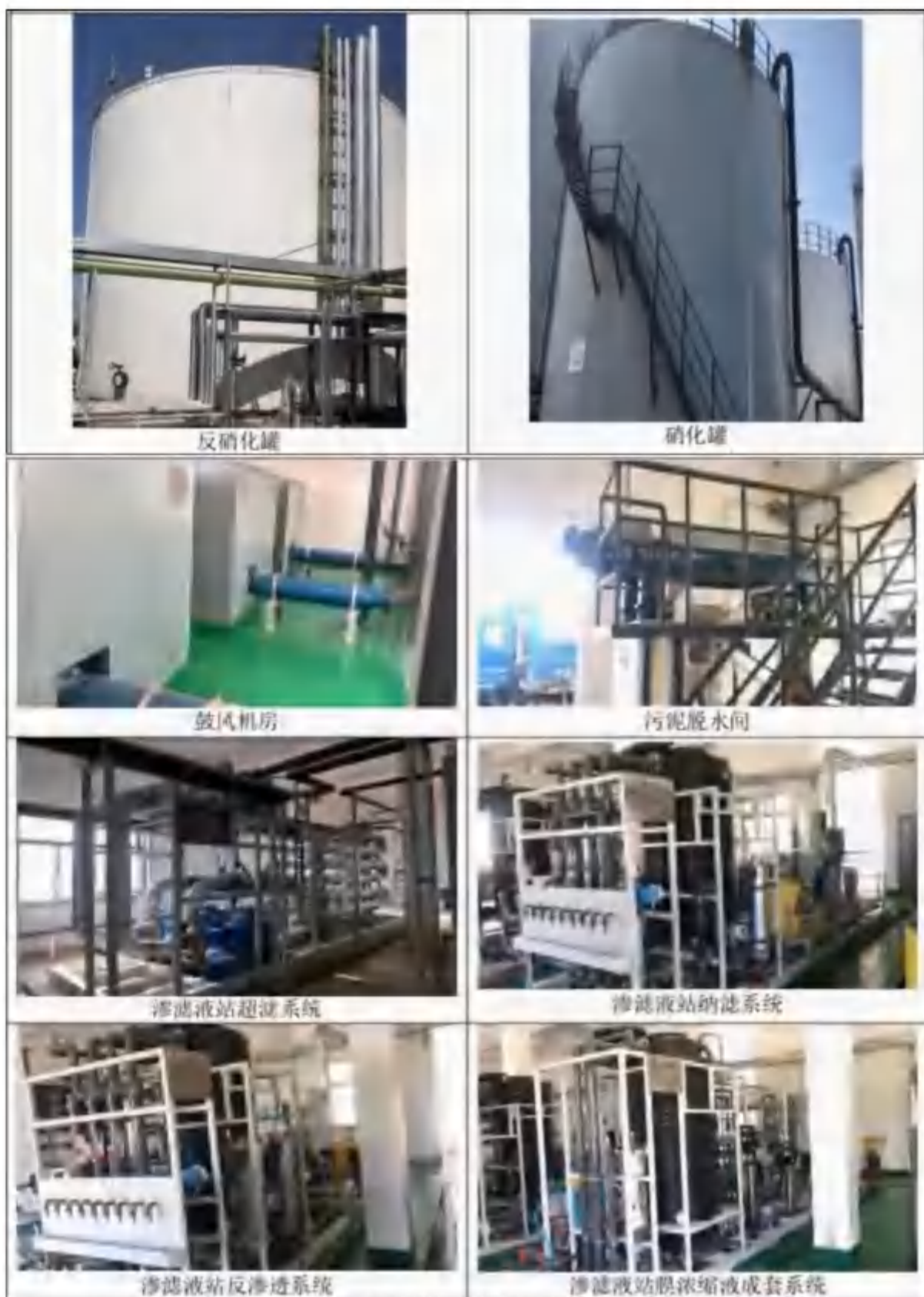
图2.3-11主要废水处理系统环保设备
